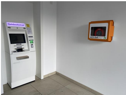
Der AED im Automatenraum im Ortsteil Oberkirchberg
